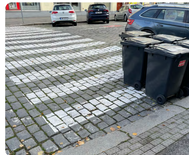
Obrázek 95 Popelnice z domu dočasně umístěné v prostoru přechodu pro chodce, zdroj: ONplan, 2025
