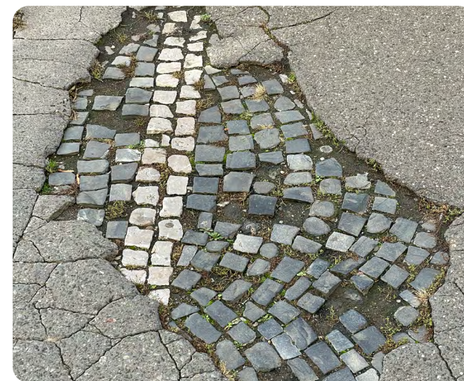
Obrázek 108 Degradovaný povrch a provizorní „záplata“ z kamenné dlažby v asfaltu, zdroj: ONplan, 2025
