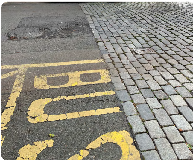
Obrázek 105 Nahodilé střídání asfaltu a kamenné dlažby v trase chodníku, zdroj: ONplan, 2025
