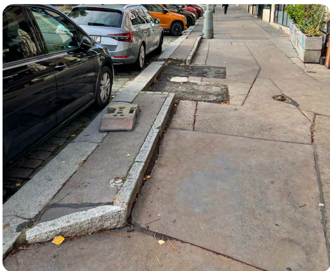
Obrázek 104 Výškové nerovnosti a lokální opravy chodníku, zdroj: ONplan, 2025
